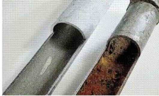
Şekil 1.1:Sulu ortamda korozyona uğramış bir parça yüzeyi (URL-1, 2014).
