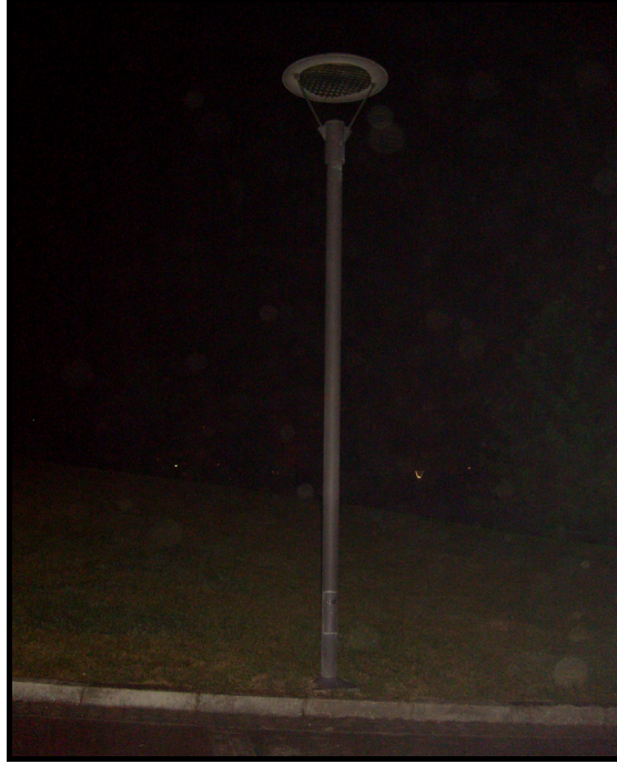
Şekil 5.30 Altınpark’ta arızalı yüksek aydınlatma (endirekt aydınlatma) elemanı örneği (Fotoğraf: Fatih Yenioğlu 2009).
