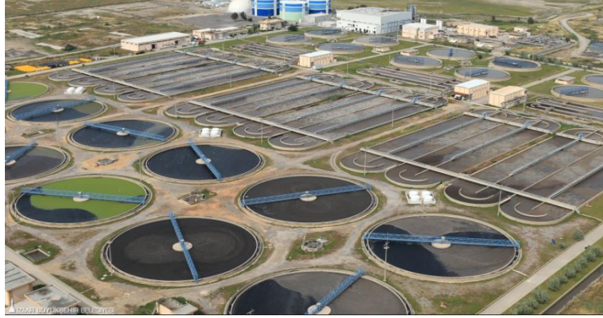
Şekil 1.17: Çiğli atık su arıtma tesisi (URL-51, 2020)
