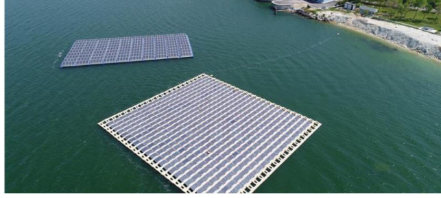
Şekil 1.13: Yüzer güneş enerjisi santrali (URL-38, 2017)
