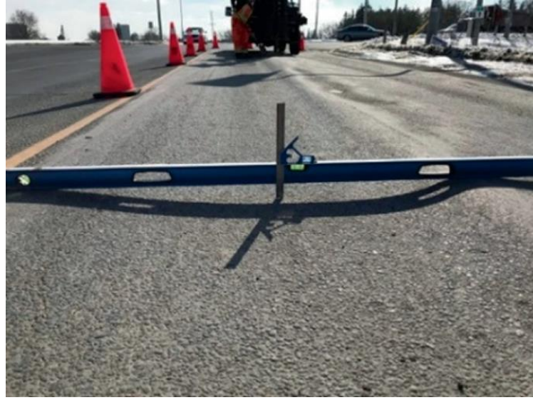
Şekil 2.9: Sathi Kaplamada tekerlek izinde oturma
