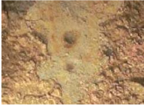
Şekil 2.9: Çukur korozyonu (URL-7, 2024)
