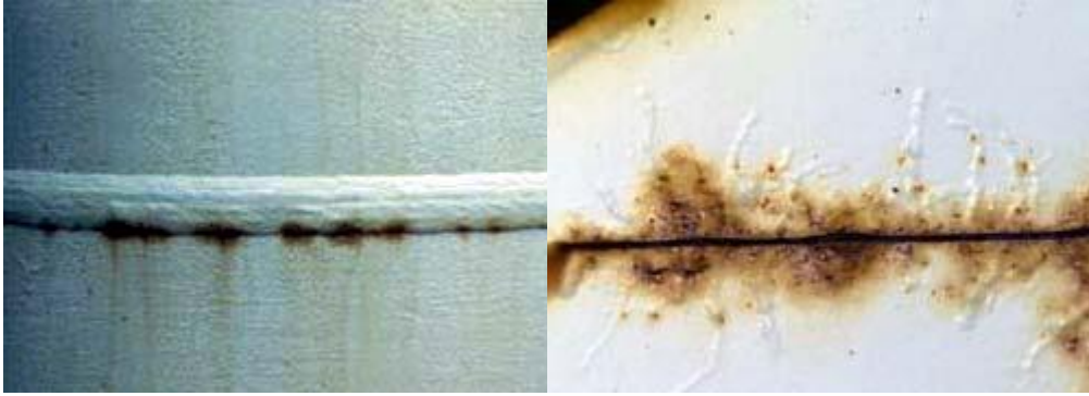
Şekil 2.11: Endüstriyel uygulamalarda filiform korozyon örnekleri (URL-7, 2024)
