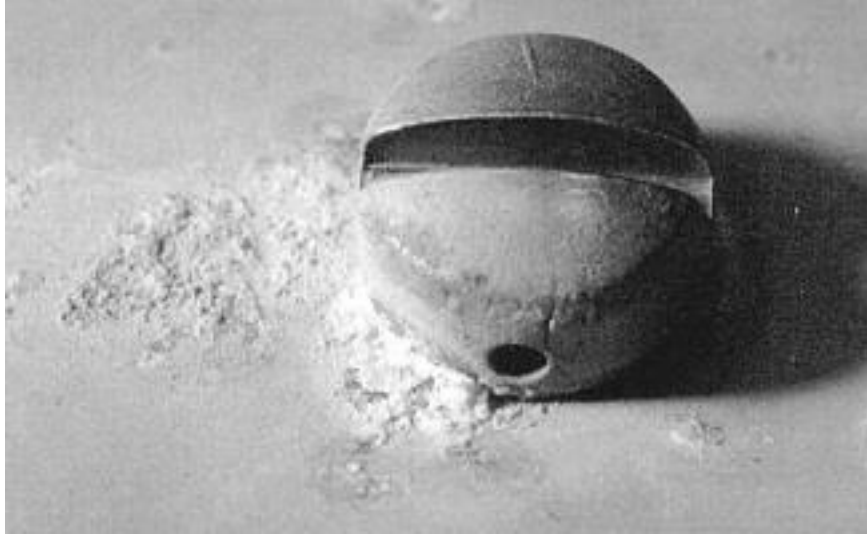
Şekil 2.5: Paslanmaz çelik civata ile alüminyum levha arasında gerçekleşen galvanik korozyon (URL-7, 2024).
