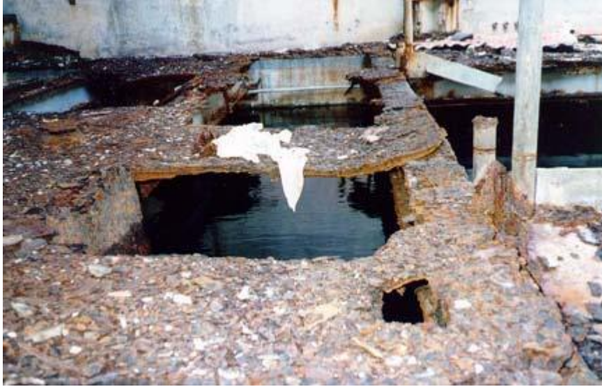
Şekil 2.3: Üniform korozyona uğramış tesis (URL-7, 2024).
