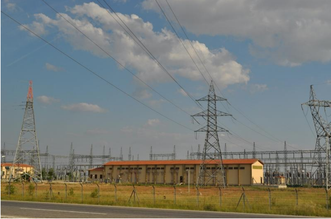
Şekil 1.2: Enerji İletim Hattı (URL5, 2019)
