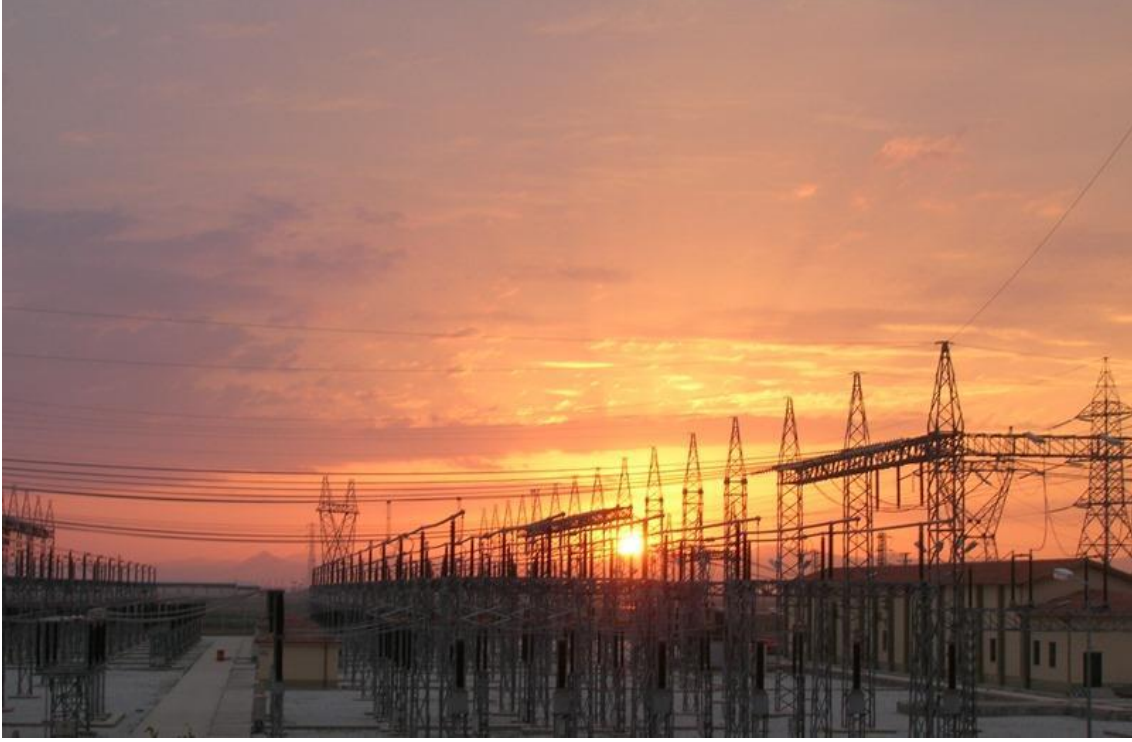
Şekil 1.3: Trafo Merkezi (URL 6, 2019)
