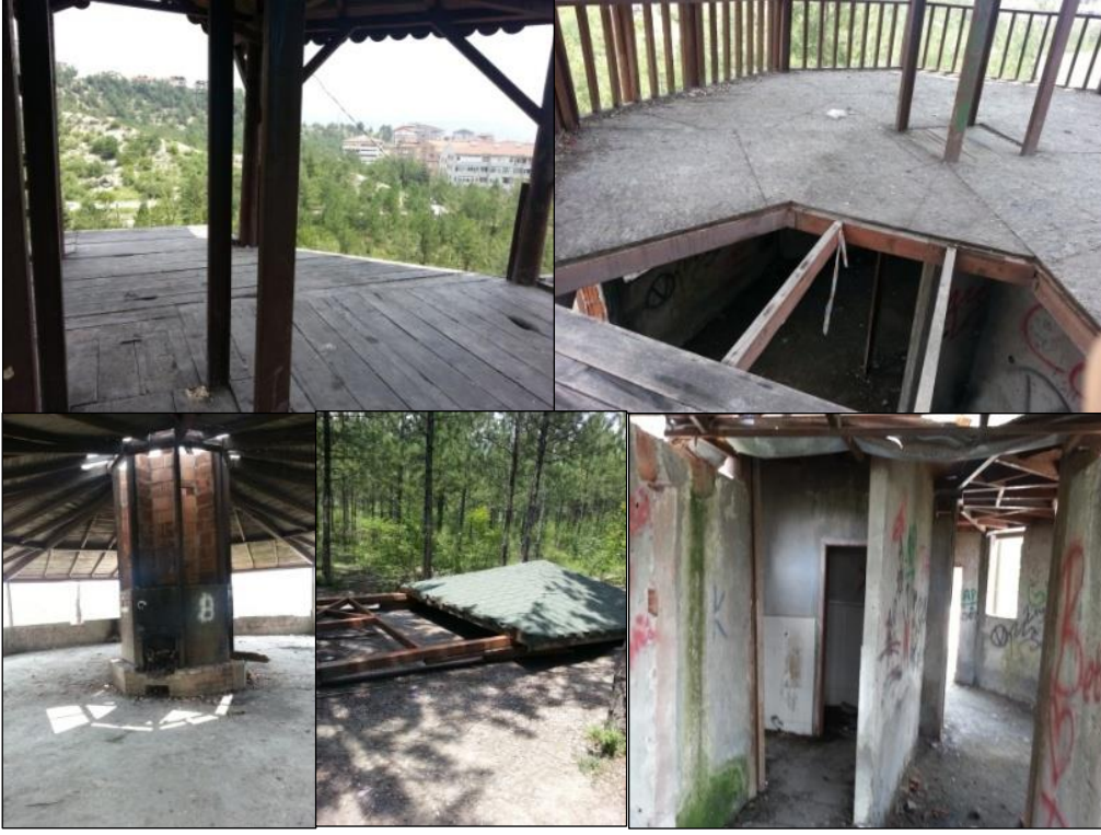
Şekil 24: Karabük Kent Ormanı'nda tesislerdeki hasarlar.
