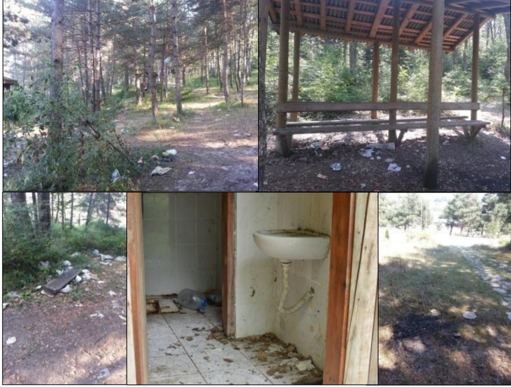
Şekil 13: Bolu Kent Ormanı'ndaki hasarlar.
