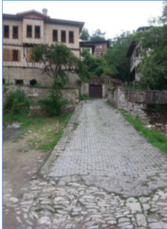
Şekil 23: Safranbolu Çarşı’da özgün taş doku ile uyumsuz yeni bir döşeme uygulaması (Fotoğraf: Çiğdem BOGENÇ 2016).
