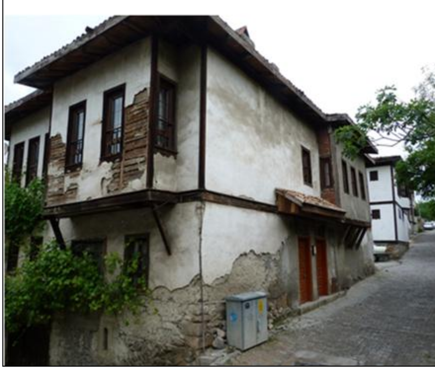
Şekil 26: Tarihi Çarşı’da restorasyonu yapılmamış konut örneği (Fotoğraf: Çiğdem BOGENÇ 2016).
