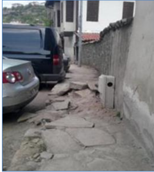
Şekil 38: DMA Safranbolu Çarşı bölgesi bakımsız kaldırım örneği (Fotoğraf: Çiğdem BOGENÇ 2016).
