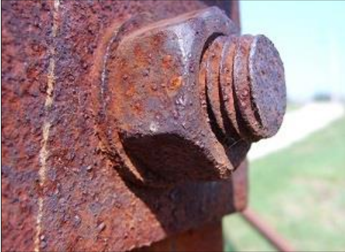
Şekil 9: Koroziyon aşınma (URL-6, 2017).
