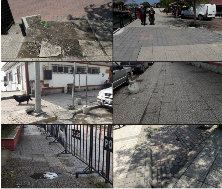
Şekil 4. 99: Zarar görmüş ve onarılmamış döşemeler (Şahin, 2022).
