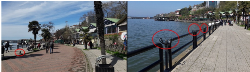
Şekil 4. 67: Eksik olan aydınlatmaların görünümü (Şahin, 2022).
