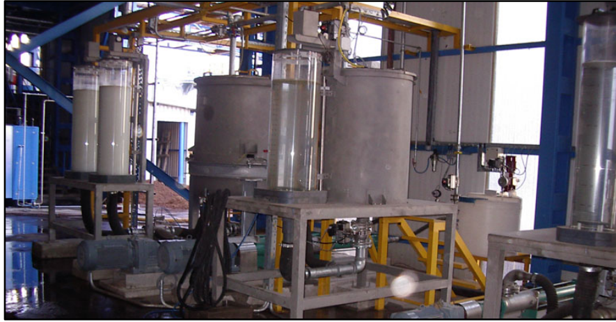
Şekil 12: Tutkallama ünitesi genel görünüşü (URL-14, 2013).
