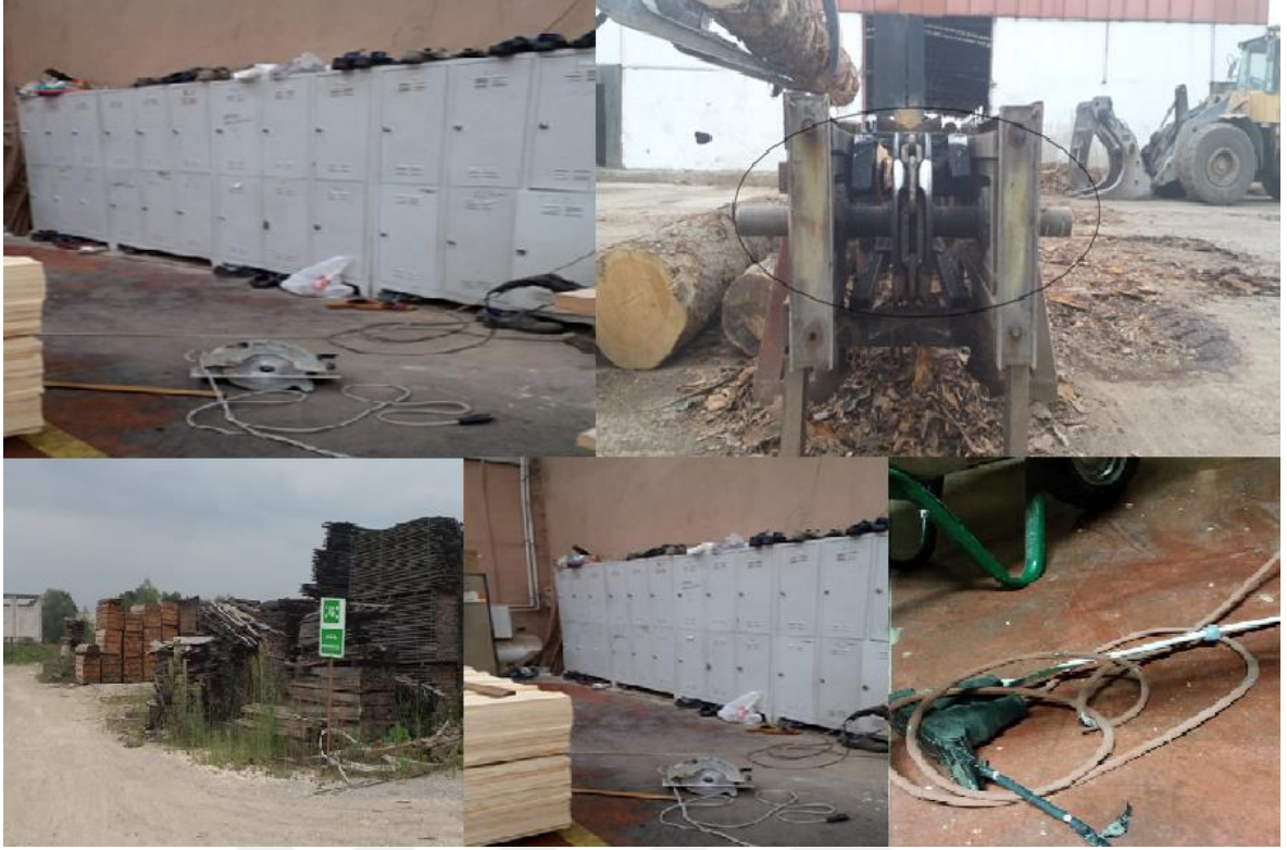
Şekil 16: Elektrik kablolarının hatalı kullanımı, zincirli sistemlerin açıkta bulunması ve acil toplanma yerinin amaç dışı kullanılması.
