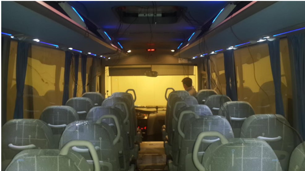
Şekil 3.24: Isıl çift yerleşimi tamamlanmış araç.
